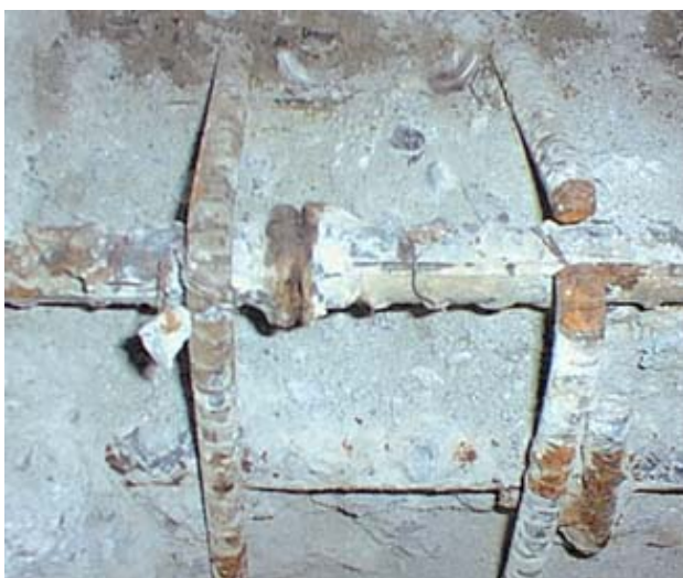
図.1 ASRによる鉄筋破断状況
