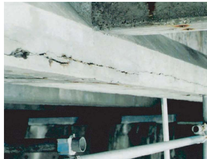
図.2 塩害によるひび割れ状況
