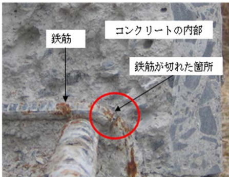
写真-1 鉄筋の破断事例
